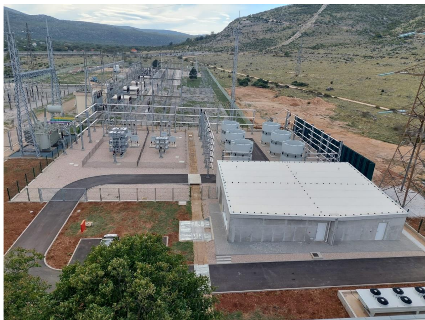
Sl. 5.: Magnetski zaslon i SVC postrojenje nakon završene montaže
