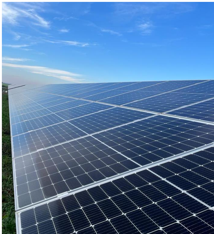
Sl. 1.: Fotografija instaliranih solarnih panela u sunčanoj elektrani velike snage
