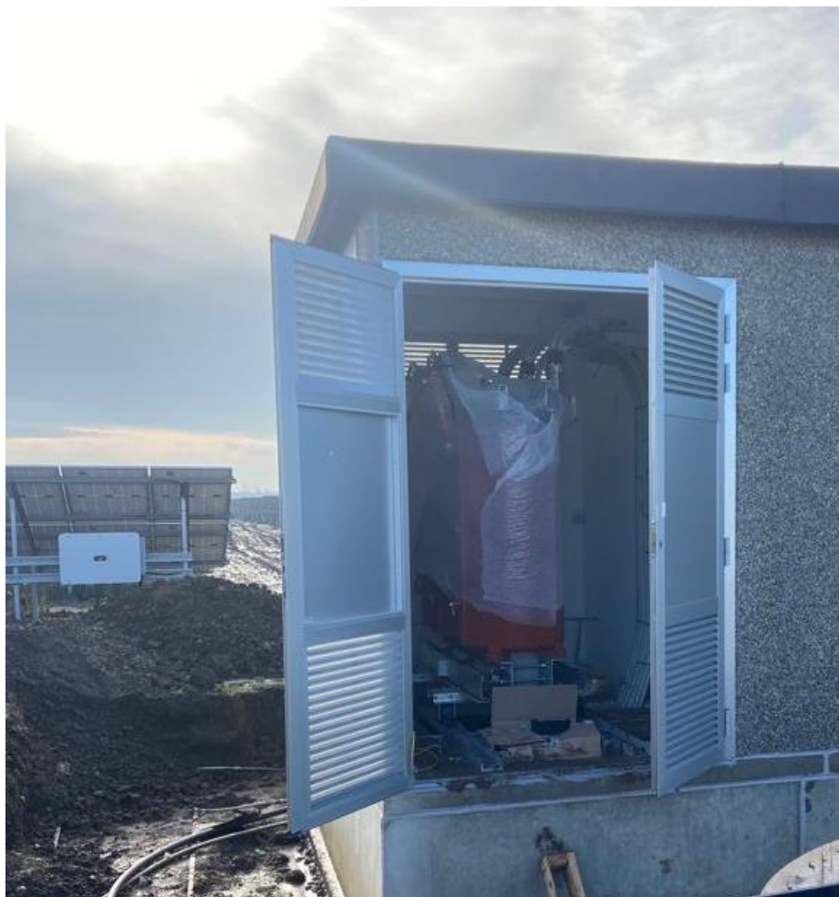
Sl. 2.: Smještaj transformatora u betonsku transformatorsku stanicu
