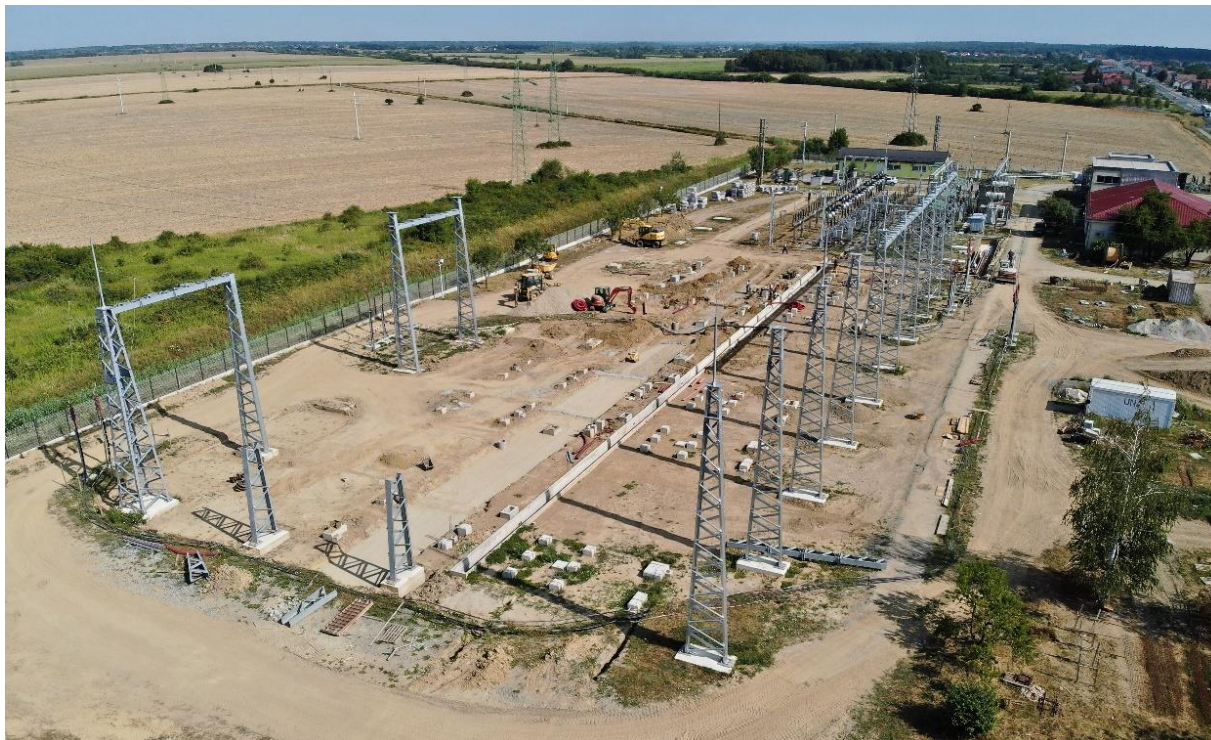
Sl. 3.: Pogled iz zraka na 110 kV postrojenje u TS 110/35/10 kV Našice – faza 1
