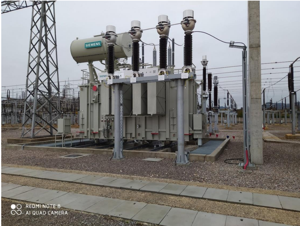
Sl. 3.: Montirana prigušnica u TS 400/220/110 kV MELINA
